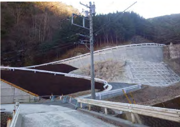
◆表彰受賞：難工事功労表彰 発注者：関東地方整備局利根川水系砂防事務所 工事名：H26さぶ沢道路新設工事 完 成：平成28年11月完成
