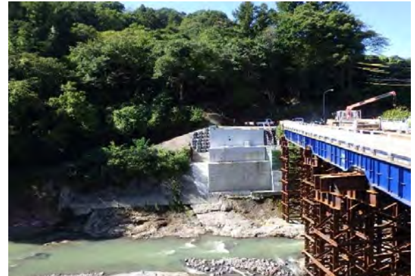
◆表彰受賞：難工事功労表彰 発注者：関東地方整備局利根川ダム統合管理事務所 工事名：H30吾妻川護岸整備工事 完成：令和3年3月完成
