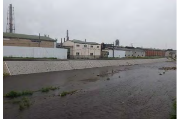
◆表彰受賞：前橋土木事務所長表彰 発注者：群馬県前橋土木事務所 工事名：河川災害復旧令和元年災第74号一級河川荒砥川左・右岸前橋市荒口町地先下荒砥橋上下流 完成：令和2年10月完成
