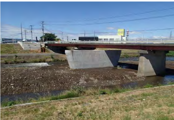
◆表彰受賞：前橋市優良工事表彰 発注者：群馬県前橋市 工事名：防災・安全交付金（道路）橋梁下部工工事 （道建第1号） 完成：平成27年6月完成
