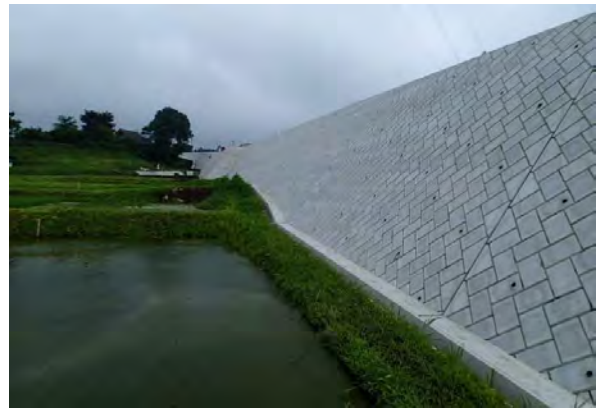
発注者：群馬県前橋土木事務所 工事名：地方特定道路整備事業 分割1号 （一）苗ヶ島飯土井線 完成：平成26年7月完成
